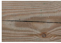
Spannungsrisse durch die Holz Trocknung
